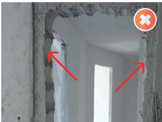
Проем не прямоугольной формы с наплывом раствора
