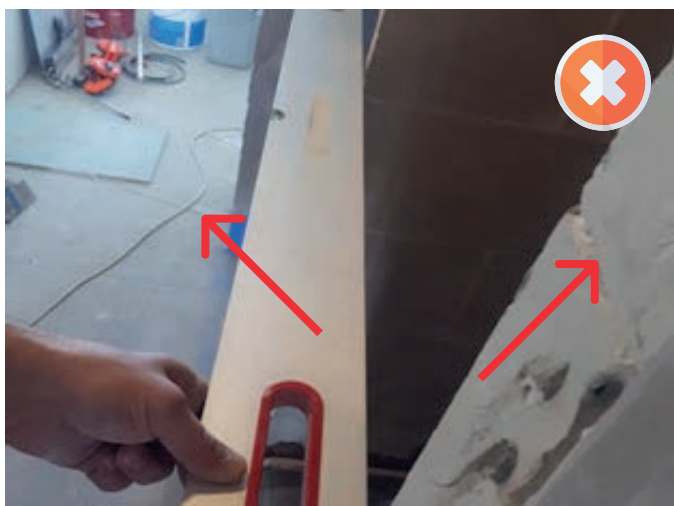
Проем не прямоугольной формы с наплывом раствора
