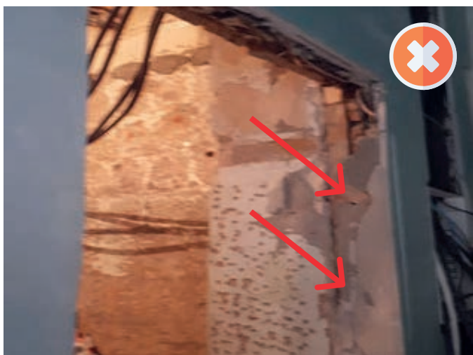
Проем с наплывами раствора и проводами
